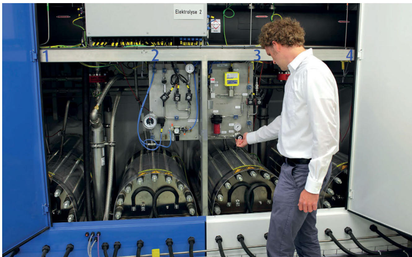
Saksamaal Hamburgis asuva Vatenfalli vesinikutankla töötaja kontrollib elektrolüüserit. Seade toodab elektrolüüsi käigus veest vesinikku, mida saab seejärel kasutada sõidukite vesinikütuseelementide toiteks
